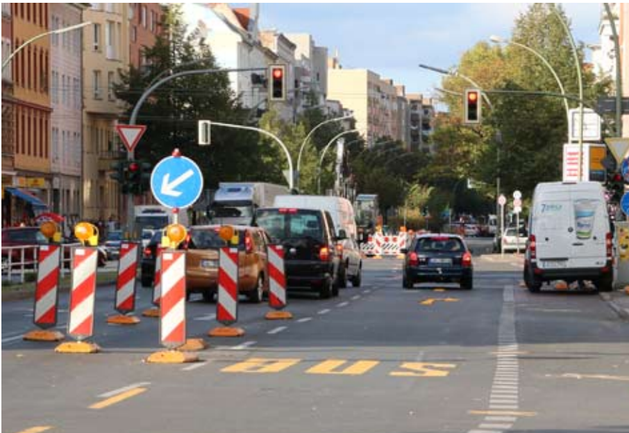
War jahrelang bei Autofahrern im Norden Berlins bekannt und ein steter Quell der Freude: Die Dauerbaustelle Osloer Straße / Prinzenallee. Wo die Schwerpunkte bei zukünftigen Investitionen in die Verkehrsinfrastruktur liegen, wo sie liegen sollten und was zerbröselnde Straßen, Schienen und Brücken die Volkswirtschaft kosten, erläutert Wolfgang Schwenk auf Seite 11 . Foto: Hanschke
