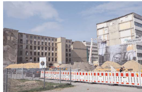
Baustelle am Petriplatz, einst zentraler Platz der mittelalterlichen Stadt Cölln. Foto: Horb
